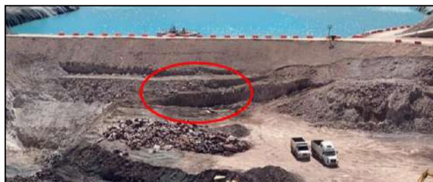
Figura 3. Zona de filtración en Dique Intermedio.
