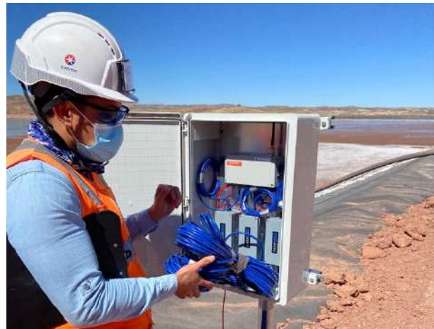
Figura 5. Ejemplo de automatización de piezómetros de cuerda vibrante con dataloggers inalámbricos.
