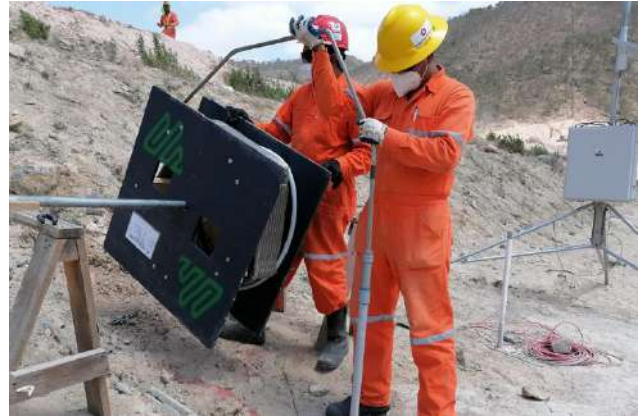
Figura 8. Ejemplo de instalación de perfilómetro SAA en presa de jales.
